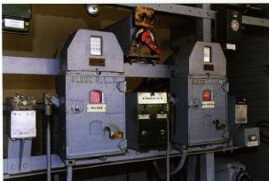
■ Toujours à Villefort, le chef de service au poste d'aiguillage. Ci-dessus, les appareils de block de voie unique, toujours marqués « PLM ». Juin 2011
