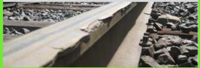
Vue de champignons de rails dégradés par fluage du métal
